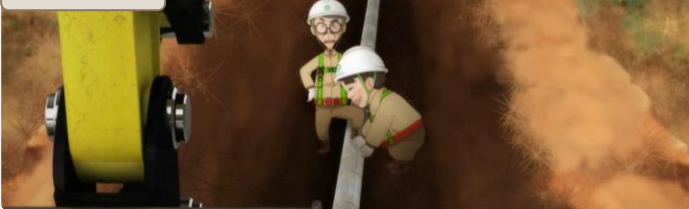
급수관로 매설공사 중 토사 붕괴
